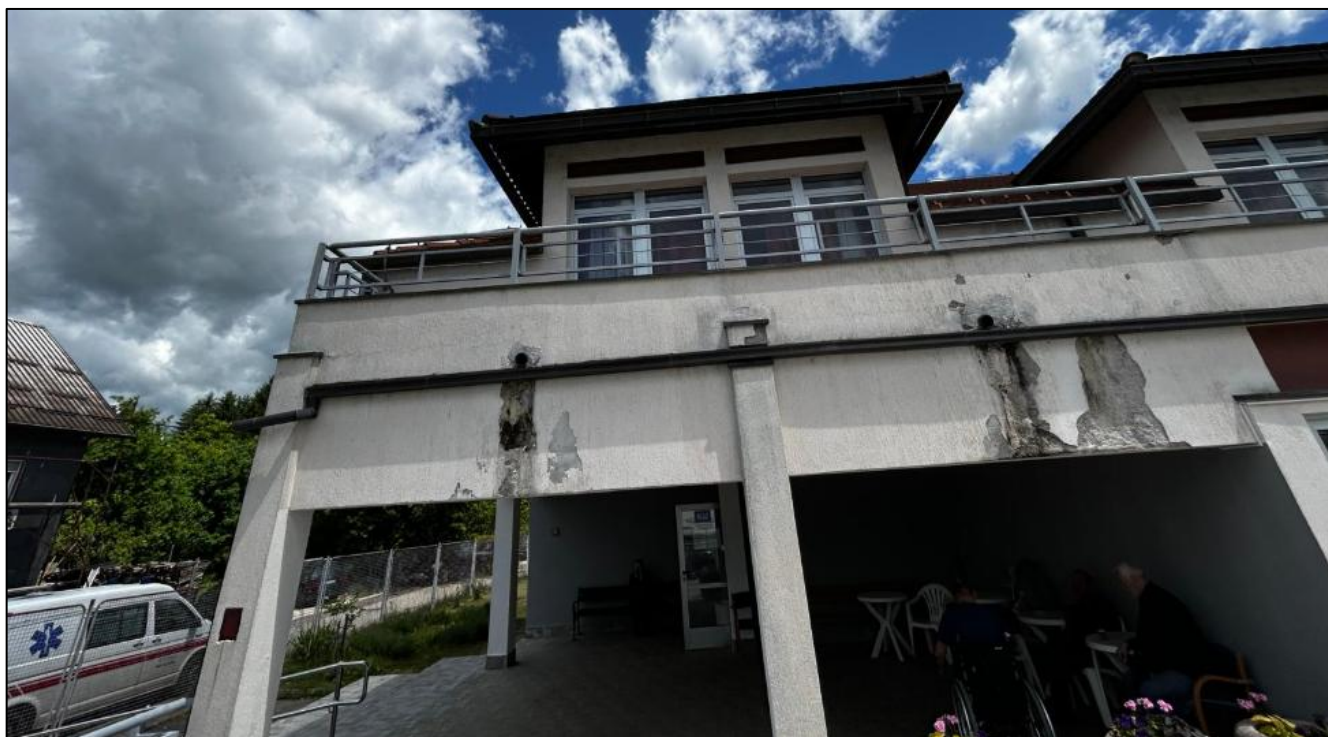
Slika 3: Jugozapadno pročelje – prikaz oštećenja na pročelju
