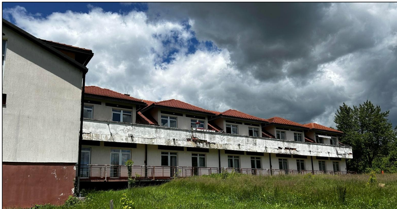
Slika 7: Jugoistočno pročelje – vanjska strana – prikaz oštećenja
