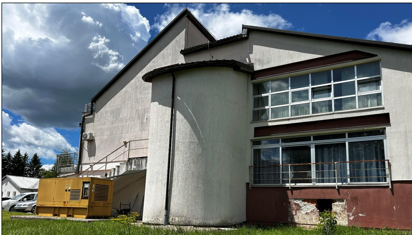
Slika 6: Jugostočno pročelje – prikaz oštećenja
